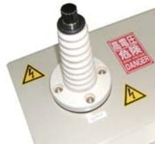
【高圧出力部】 (碍子部分)
